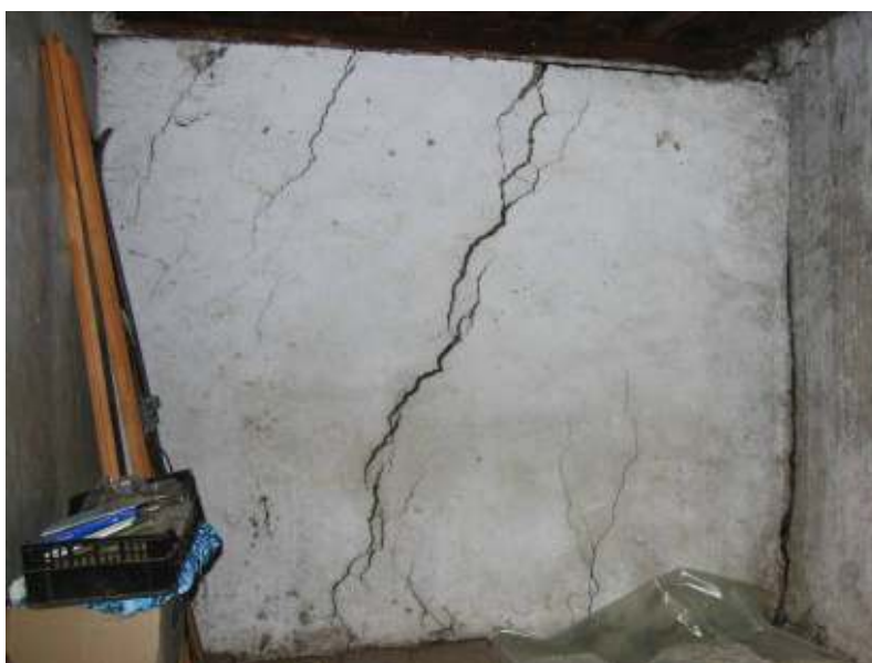
Večja konstrukcijska razpoka na S steni gorenje kamre.
