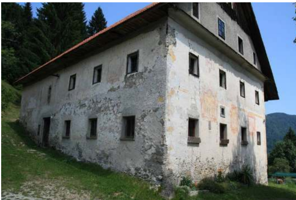
Zaradi poškodb na ometu, predelanih okenskih površin, poškodovanih poslikav deluje objekt na zunaj zanemarjeno.
