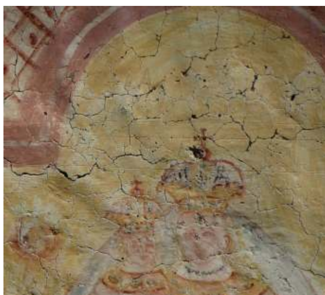
Del razpok in poškodbe v ometu je estetske narave.
