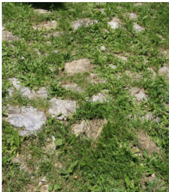
Obstoječe kamnito zunanje tlakovanje, zaraščeno s travo.
