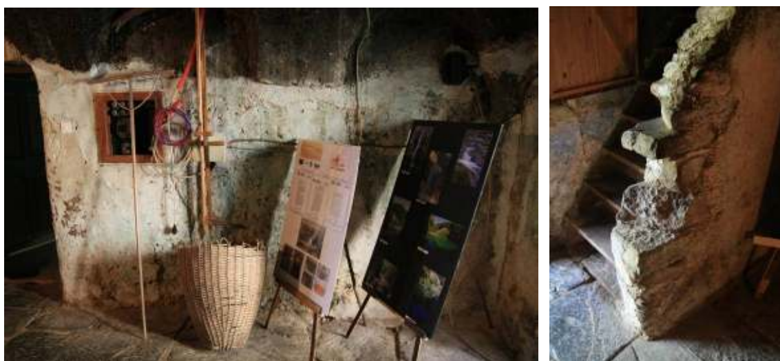
Levo: Stena proti »hiši«. Vidna elektro omarica in instalacije. Desno: Poškodovana stena stopnic v nadstropje.
